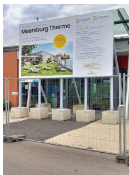
An der Therme in Meersburg laufen die Arbeiten für Erweiterung und Umbau. Jetzt fand sich auch eine Firma für die Elektroarbeiten. BILD: JENNA SANTINI
